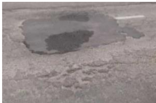
Rajah 2.11: kegagalan tambakan
