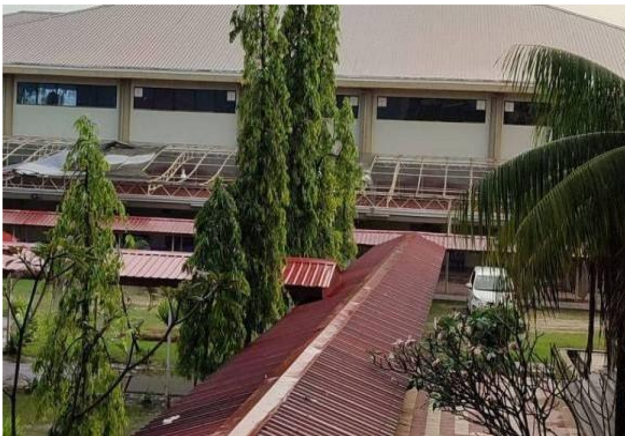
Keadaan bumbung bangunan Politeknik Shah Alam rosak. Foto: Facebook PSA
