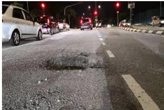
Rajah 1.1 Jalan Berlubang
